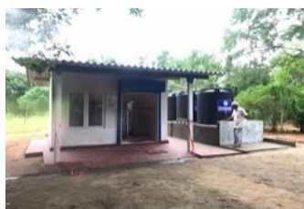
設置された膜ろ過浄水システム
