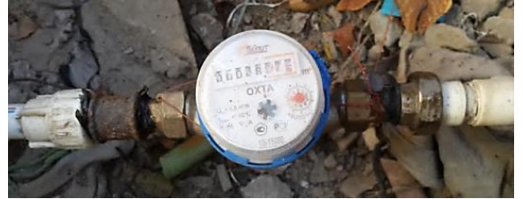
ロシア製の水道メーター
