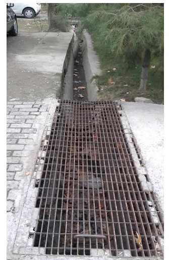
一般的な雨水・融雪水排水路
