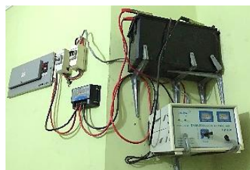
ソーラー発電システム (変換機、分電盤、電力量計等)
