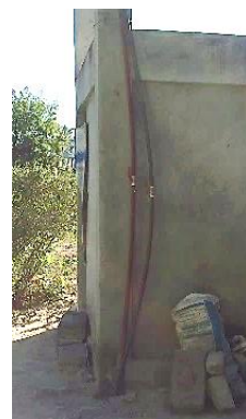
高置水槽から家屋内に引き込む水道管
