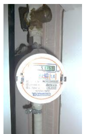
ガスメーター
