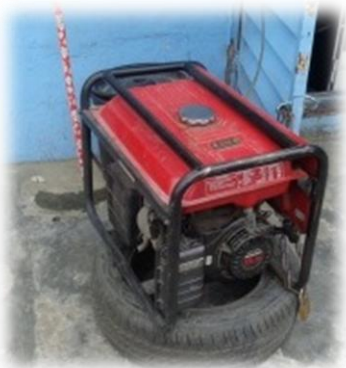
停電時用の発電機
