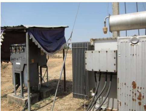
発電機の電力を工場に送り込む送電網(写真右)と、ナショナルグリッドと切り替えるための切り替え装置(同左)
