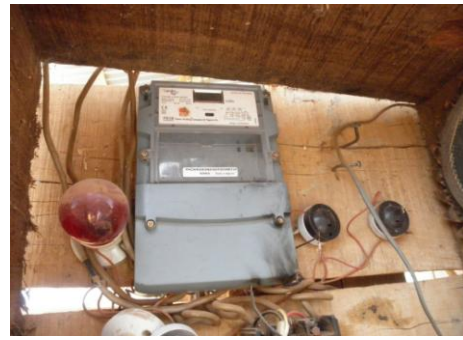
電気メーター。実際はメーターの検針に従って支払っている世帯はほとんどない。
