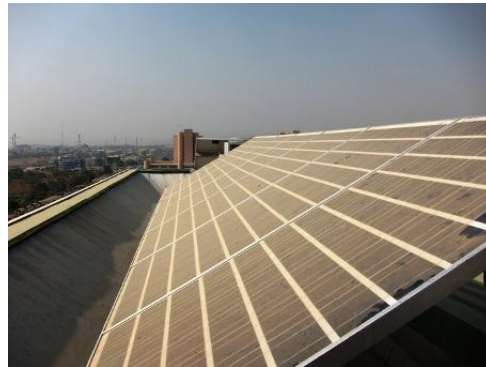
屋上に設置されたソーラーパネル。ソーラーのエネルギーでは十分なパワーが期待できないので、廊下の照明用になるとのこと。
