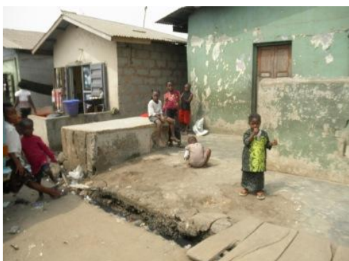
排水路自体の作りも良くないが、中にゴミが堆積している(ラゴス都市部)
