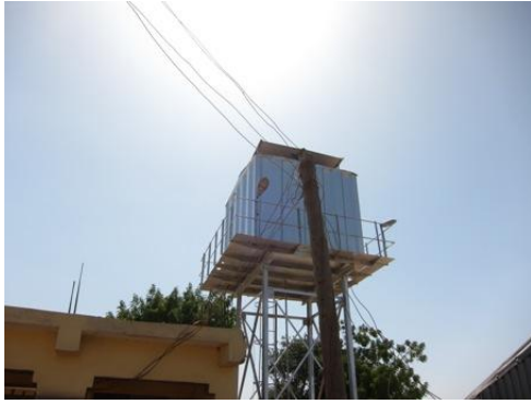
ソーラーパネルはタワーの頂点に設置されている(カドゥナ郊外の貯水タンク)
