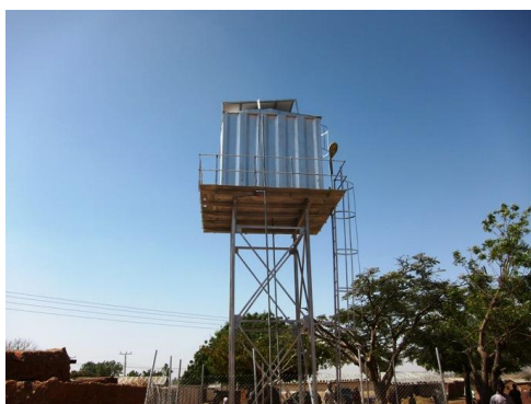
貯水タンクは水の品質や設備の安全性確保から高層に設置され、関係者以外は立ち入りできない仕組みとなっている。
