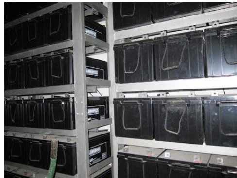
ソーラーパネルのエネルギーは別の部屋にある大量のバッテリーに蓄えられる。
