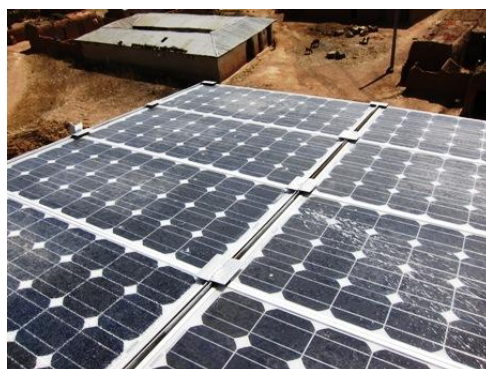
貯水タンク上部に取り付けられたソーラーパネル。パネル表面には一見して分かるほど多くの傷が見え、管理状態は必ずしも良くない。
