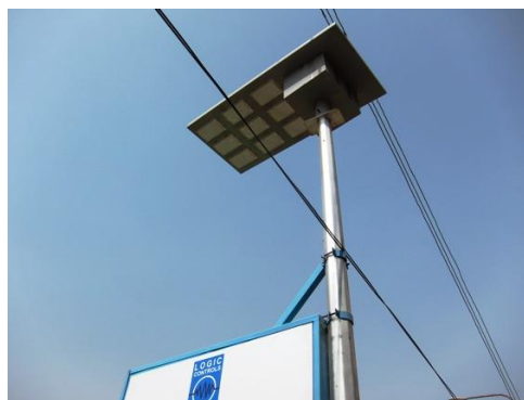
左の写真と同じ店舗前の看板に設置されたソーラーパネル。店舗前の駐車スペースの照明に利用し、防犯対策を兼ねているとのことであった。
