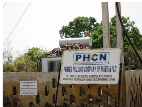
PHCN(電力会社)から送電を受けていることが分かる看板と装置
