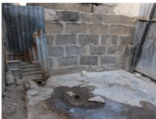
カドゥナ郊外にある穴式トイレ 穴を中心に水が周辺へ流れ出していた。
