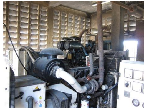
建屋内の大型発電機
