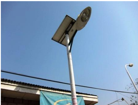
ソーラーパネル式の街灯(四角い部分がパネル)
