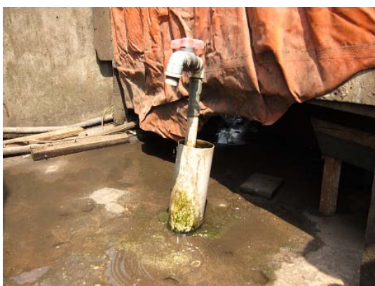
ラゴス Badiga(BOP 層居住地区) 共同の水道
