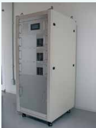
UPS(無停電電源装置)
