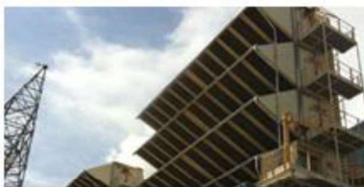
写真 1-2. GT 吸気フィルタ室外観
