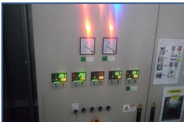
図 5-6 塗装設備管理用デジタルメーター
