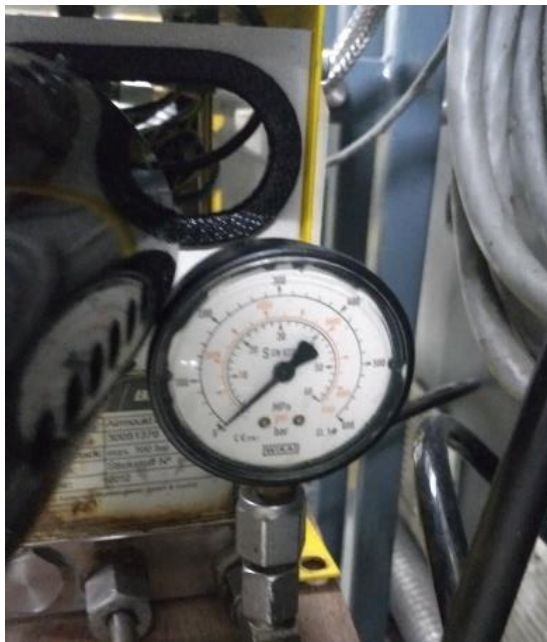
図 5-5 ガス供給配管用アナログメーター
