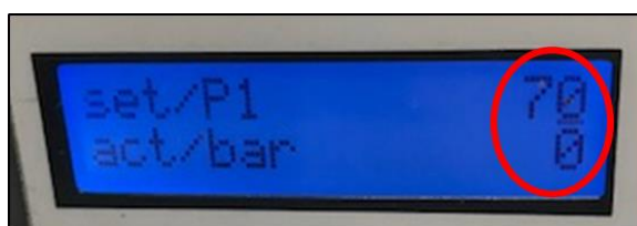
図 6-2 Daiwa Kasei 実証実験データ取得不可メーター
