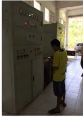
制御盤、励磁用変圧器の配列
