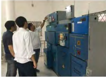
高圧開閉器盤 (20kV switchgear)
