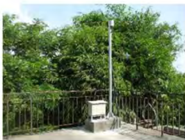
水位センサー設備
