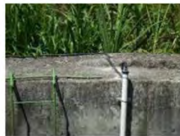
取水口 水位計取付上部
