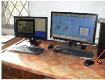
水位データ及び水路映像システム用 PC(左側)
