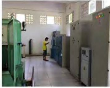
開閉器盤、分電盤の配列
