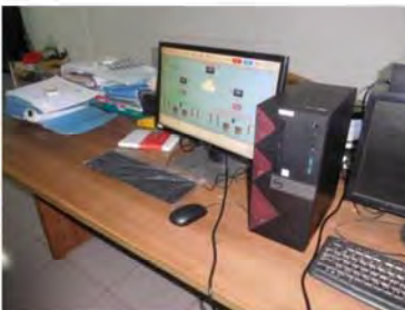
中央監視所の SCADA
