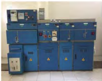
高压開閉器盤 (20kV switchgear)
