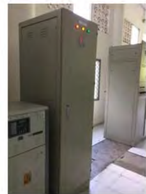
所内電源分電盤
