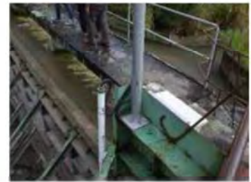
発信器3 水位計上部 バッテリーボックス
