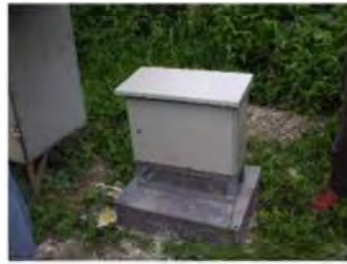
中継器2 (現地オフィス) バッテリーボックス
