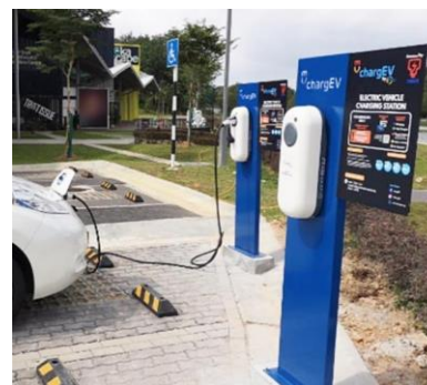
EVステーション
