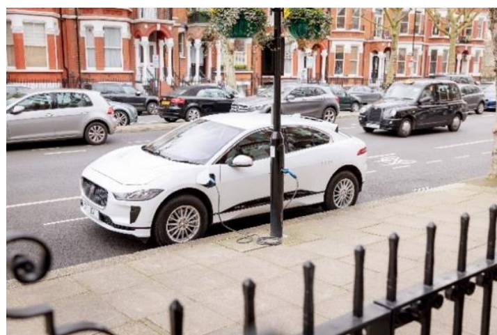
図表 36 : 街灯 EVSE (2)
