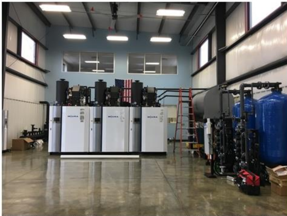
ミウラのボイラー。飲料ボトルの洗浄など、食品・飲料メーカーからの需要も多い(ジェトロ撮影)
