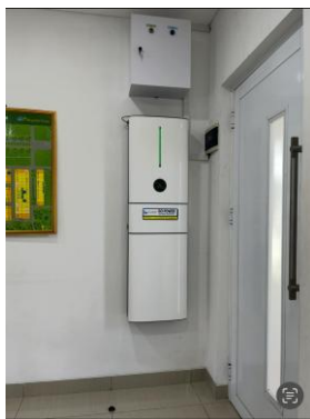
自立型高効率電源システム
