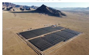
太陽光発電・蓄電池
