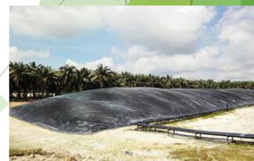
Pembangkit listrik biogas
