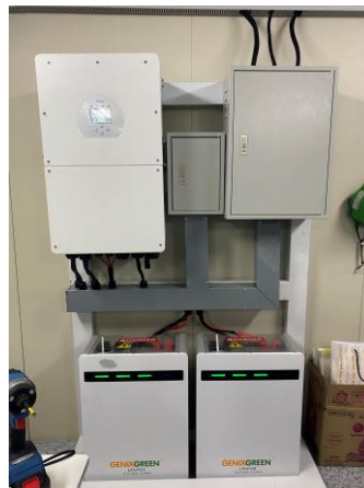
Peralatan sistem tenaga (baterai & inverter)
