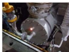
加熱炉内スキッド 長寿命化
