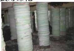
熱処理炉（煉瓦→断熱材）
