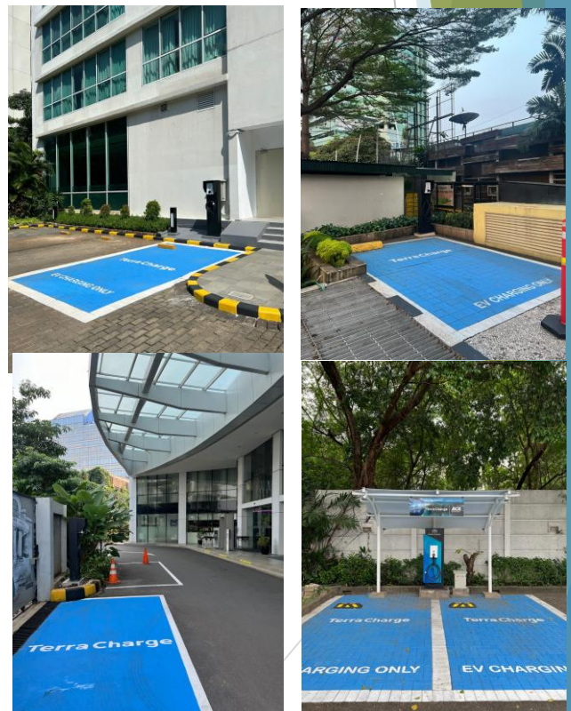
EV充電設備の導入事例
