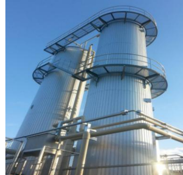
EGSB WWTP (2.6Φx15H)
