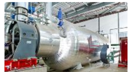
Pembangkit Listrik Tenaga Limbah Panas
