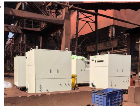
4 NEFS dipasang di sebuah perusahaan baja India
