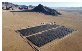
太陽光発電・蓄電池
