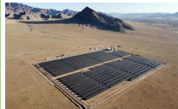
太陽光発電・蓄電池
