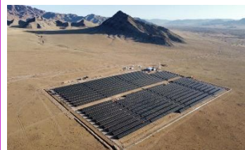
太陽光発電・蓄電池
