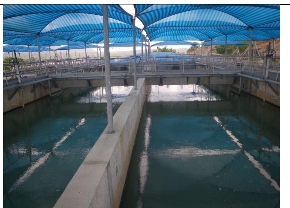
写真4：水処理施設 (ETA)
