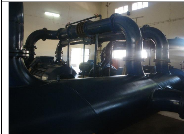
写真5：ETA3 内のポンプ
