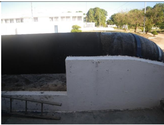
写真6：ETA3 の送水管
