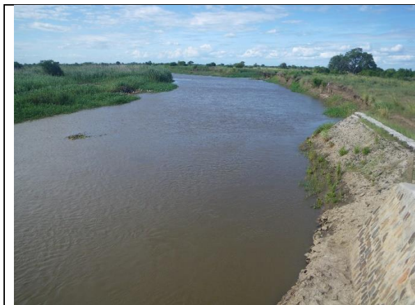
写真1：取水堰前方のプングウェ川-左岸に侵食あり
