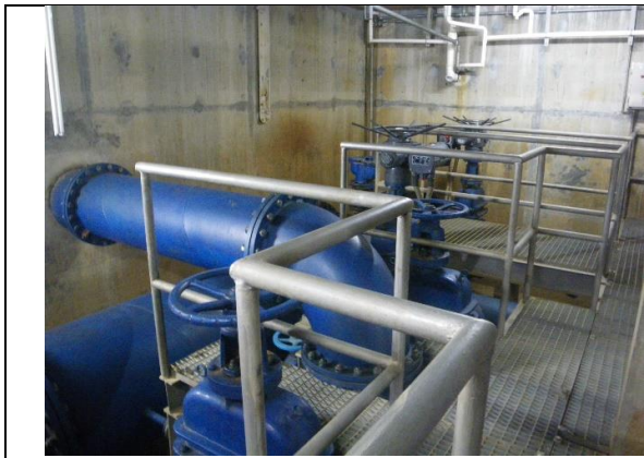
写真3：取水堰内のポンプ - 4 台中 3 台稼働
