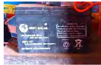
屋内においてあるバッテリー
