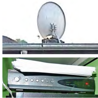
衛星放送受信用アンテナ(上写真)とテレビチューナー(下写真)
