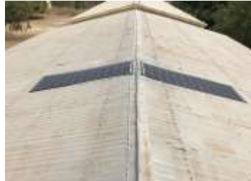
図 17. 屋根に設置のフィルム型ソーラーシート
