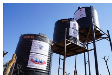
ソマリアで稼働中の簡易浄化装置
