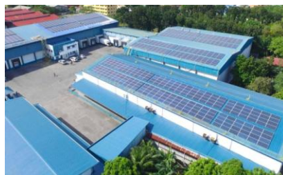
顧客名 : Fast-Koldstor 設置容量: 503.05 kWp
