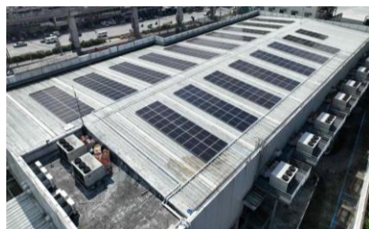
顧客名 : Decathlon 設置容量: 225.06 kWp
