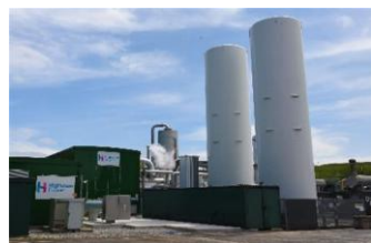
マンチェスター（英国） 運転開始：2018年 容量：5MW、15MWh 商用実証プラント
