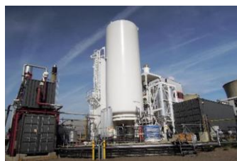
ヒースロー（英国） 運転開始：2011年 容量：350kW、2.5MWh パイロット実証プラント
