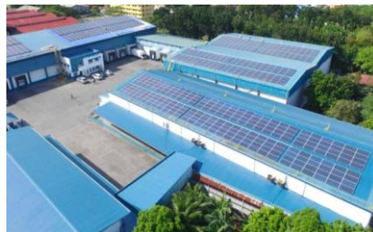
顧客名 : Fast-Koldstor 設置容量: 503.05 kWp
