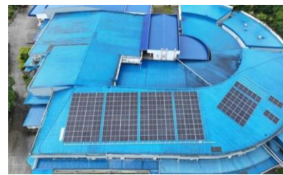
顧客名 : AM-Europharma 設置容量: 115.2 kWp
