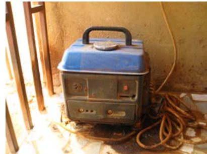
アブジャBOP層家庭にある発電機
