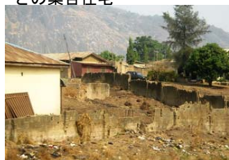
アブジャ郊外 首都のアブジャでもBOP層の住宅環境は良くない
