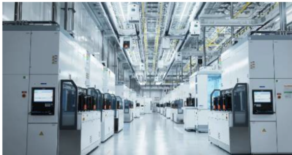
[半導体製造工場]
