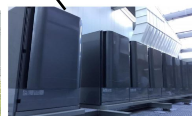
横浜市新市庁舎様 (200kW)
