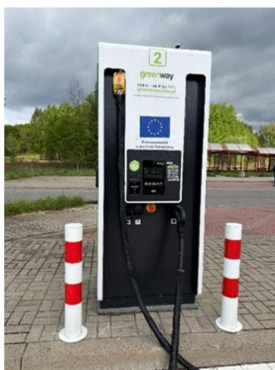
高速道路沿いに設置されているDC急速充電器（ジェットロ撮影）
