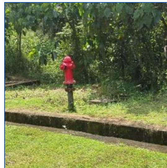
区域内に設置された消火栓
