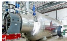
排熱回収発電
