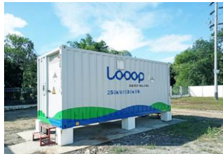
コンテナ型蓄電池
