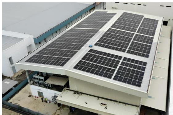
太陽光発電 265.98kWp (マレーシア)
