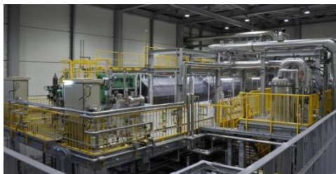
大型アルカリ水電解設備
