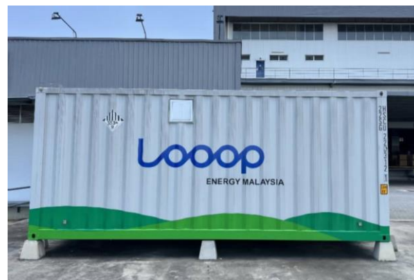
蓄電池 (BESS) 500kWh (マレーシア)
