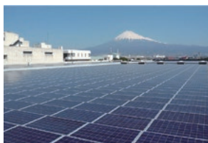
写真提供：ソーラーパワーネットワーク
