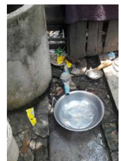
YCDCの配水管による水道の蛇口
