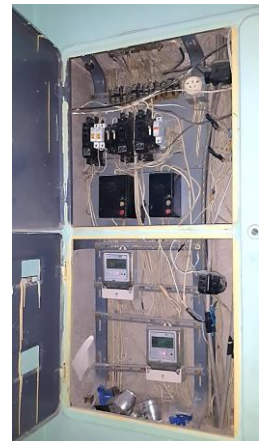
アパート2棟に配電しているブレーカー付き配電盤。
