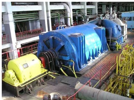
タシケント火力発電所
