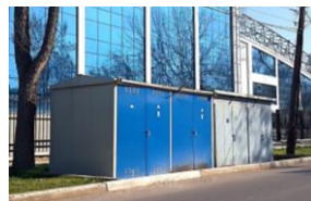
街路上の変圧設備
