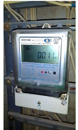
中国製部品を国内で組み立てた電気計測メーター。ウズベキスタンの家庭で一般的に使われている。
