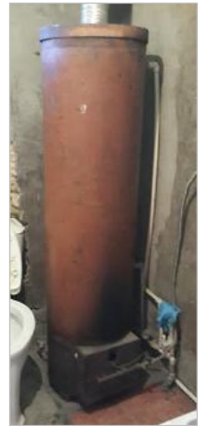
浴室と台所給湯用のガスボイラー
