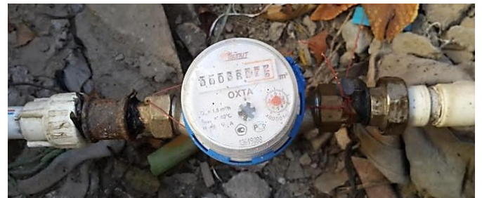
ロシア製の水道メーター
