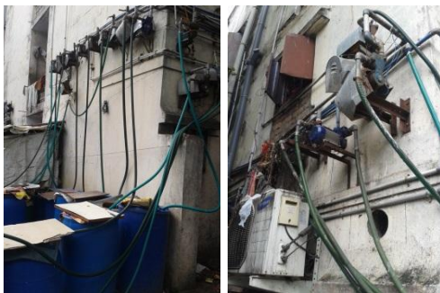
大きなタンクとポンプが1階の屋外に置かれている。
