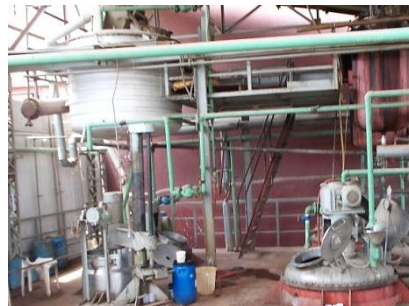
反応設備(工場内2階)
