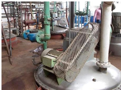
反応設備(工場内2階)
