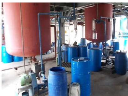
反応設備(工場内1階)
