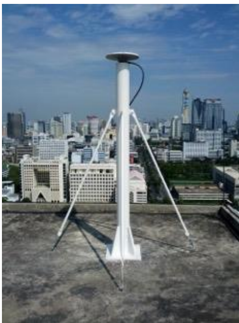
図 8.1.2-2 Chulalongkorn 大学に設置されているローカル補正用基準局
