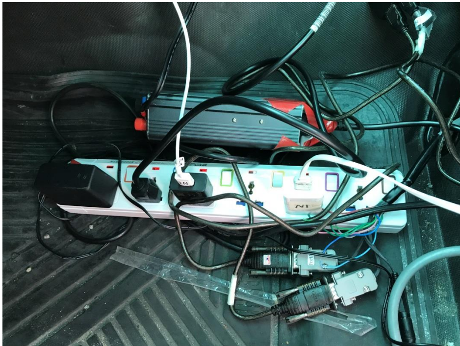
図 5.2.2-7 トラックにおけるバッテリーの設置及び配線状況の様子
